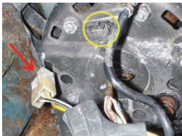
شکل ۳-۳۵ - جدا کردن کاتوچویی سیم کشی لامپ شارژ
